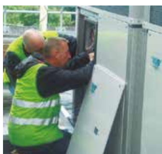
Krajowy System Elektroenergetyczny, renowacja call centre w Hinkley, Wielka Brytania. ECO G
